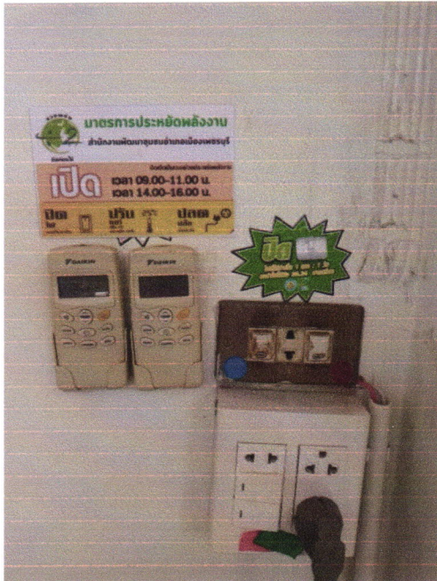
ปรับอุณหภูมิเครื่องปรับอากาศ อยู่ที่ ๒๕ องศา
